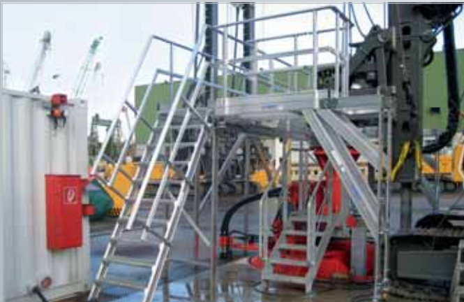
Plataforma de mantenimiento
