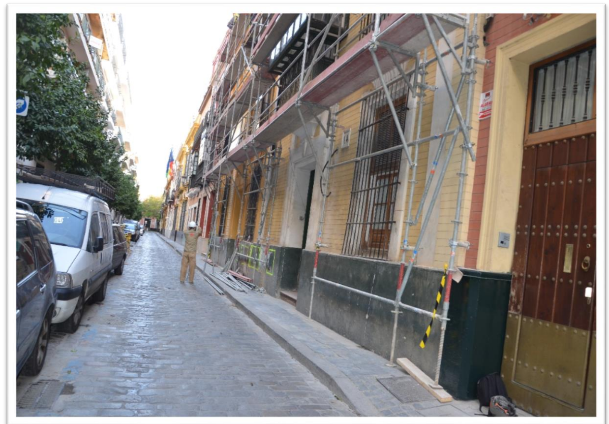
Un solo pie para permitir el paso por la acera.
