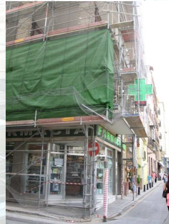
Andamio volado desde estructura interior y con pies estrechos.
