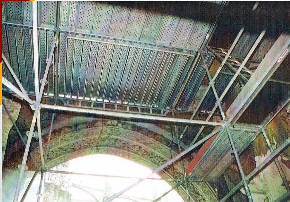
Restauración del artesanado de la Puerta del Perdón Creación de una plataforma para la ejecución de los trabajos
