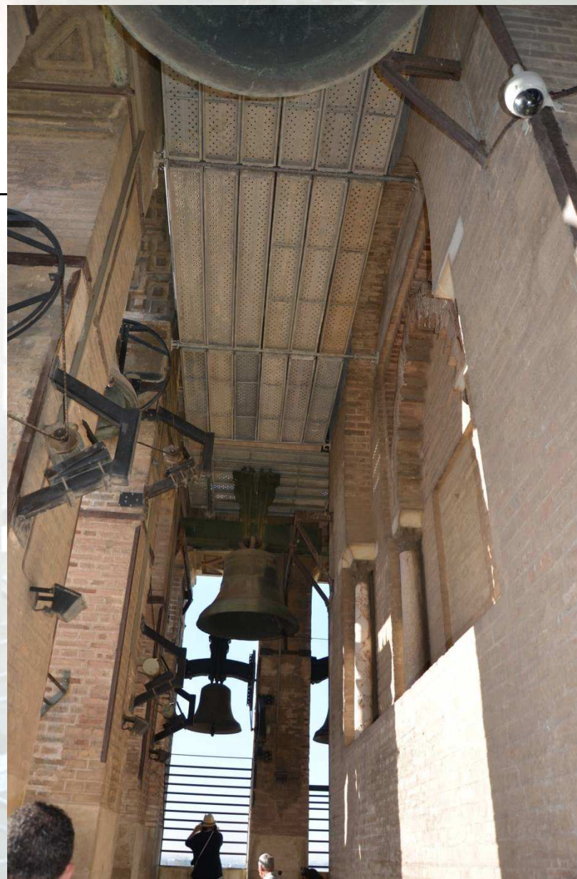
Plataforma para limpieza de las bóvedas del cuerpo de campanas de la Giralda. Como requerimiento no interferir al turismo.
