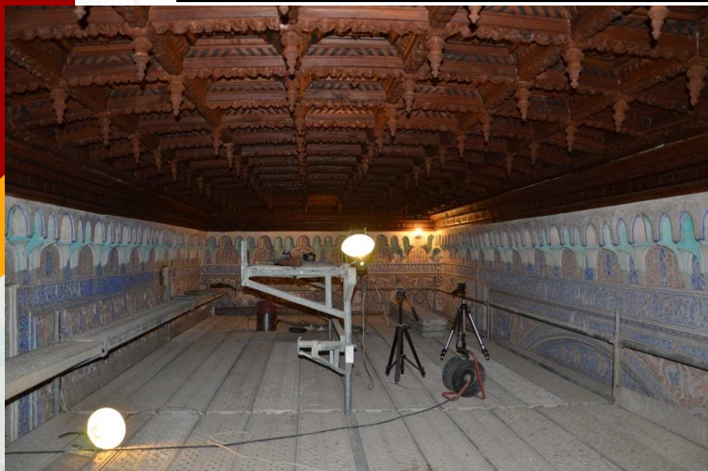
Restauración del artesanado de la Sala de Toledanos de los Reales Alcázares de Sevilla.
