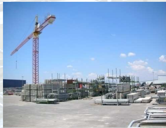
CAMPA DE ALMACENAJE
