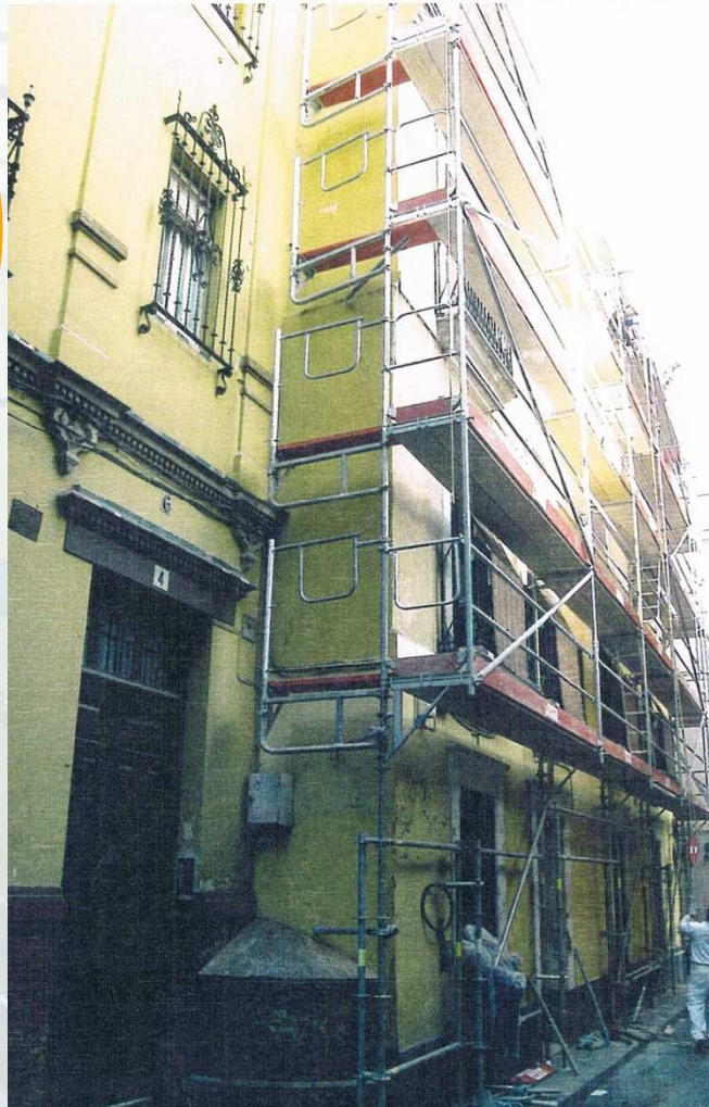
Andamio en calles con Acerados muy estrecho y consolas laterales en entrante de fachada.
