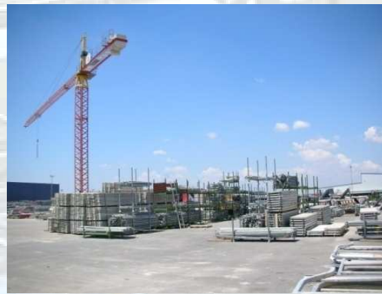
CAMPA DE ALMACENAJE
