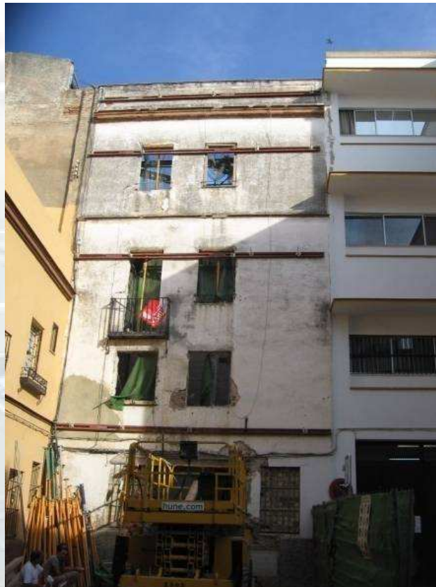
Estabilizador interior, vista exterior correas de fachada
