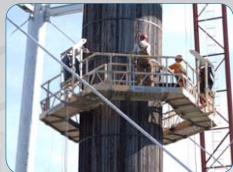
Plataforma con angulares fijos y liras en "C"
