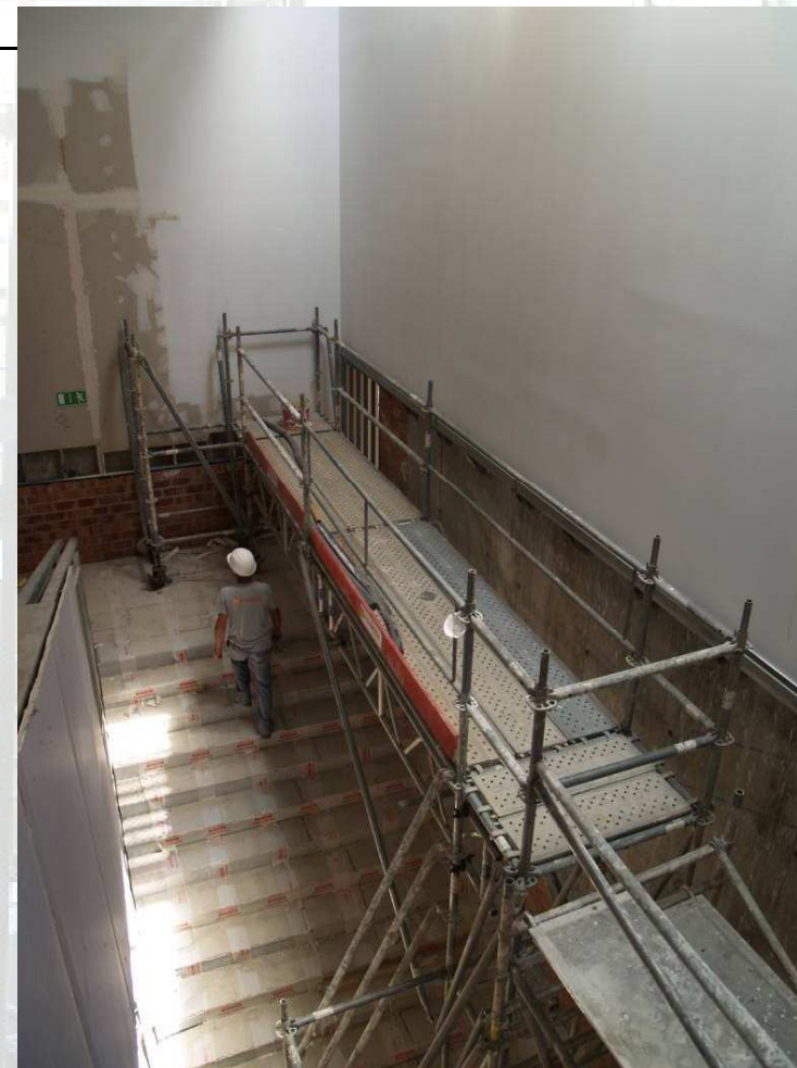
Palacio de San Telmo (Sevilla) Torre móvil adaptada al desnivel de una escalera.
