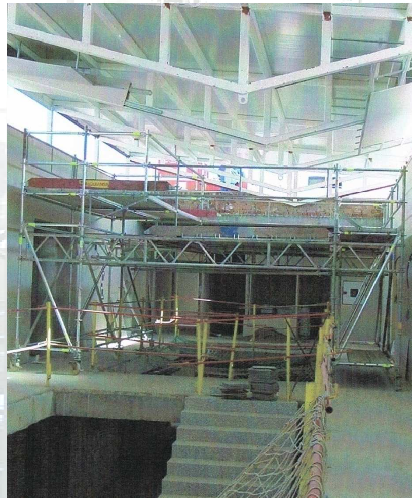
Torre doble móvil con pasarela entre pasillos adaptada a la forma del techo.
