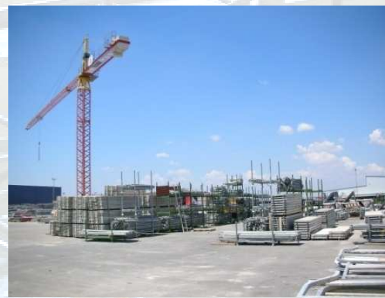
CAMPA DE ALMACENAJE
