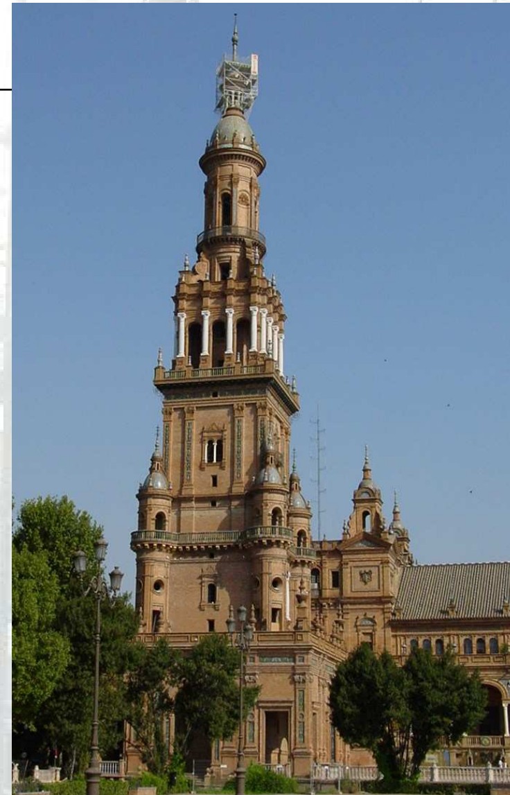
Torre Norte Plaza de España (Sevilla) Arq. Aníbal González (1914-1928) Andamio para cambio de pararrayos. Estructura que volada desde el último cuerpo de la torre.
