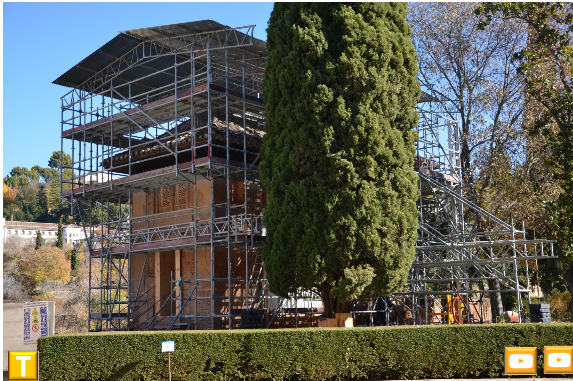
Restauración de las cubiertas del Oratorio del Partal en La Alhambra de Granada..
